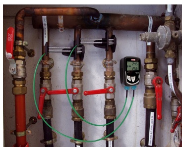
Lutte contre les légionnelles : contrôle des réseaux ECS
